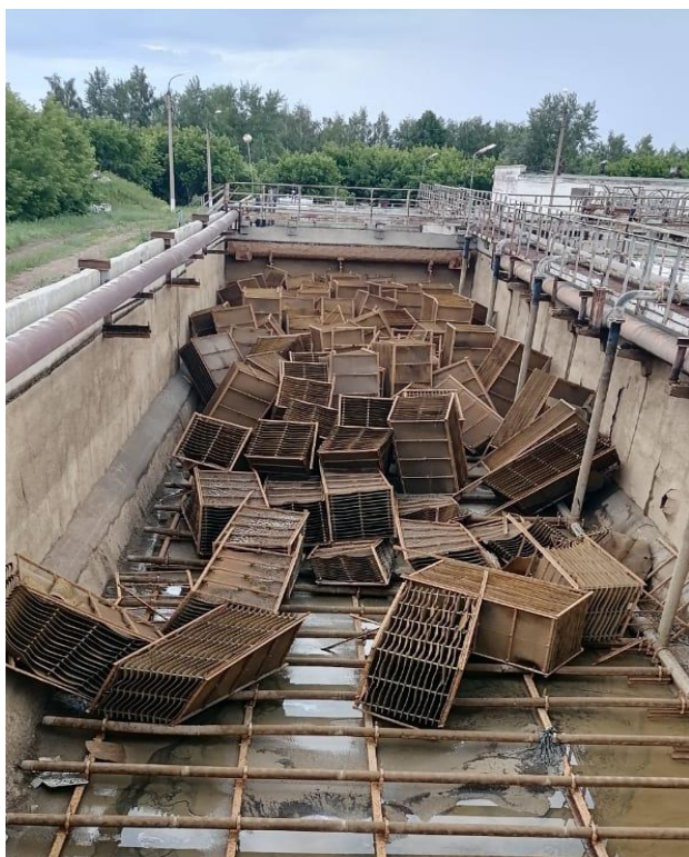
Рис. 1. Коридор с разрушенными кассетами
